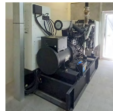
E já possibilitou a compra e instalação de um gerador de energia
